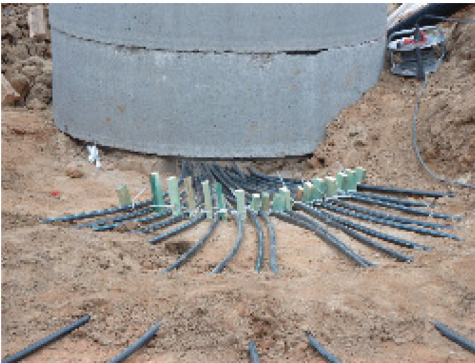
Schacht mit Vor- und Rücklaufverteiler
